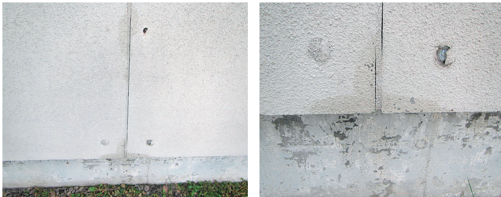
写真3 複合板間シーリングの切れからの水の浸入と滲出、ファスナー頭部における剥離 (右は接写)
