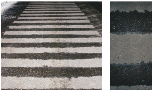
写真-13 屋外試験の路面状態 (左: 全体 右: 拡大)
