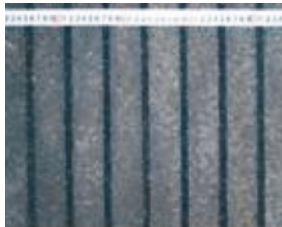
写真-1 G-9の舗装表面
